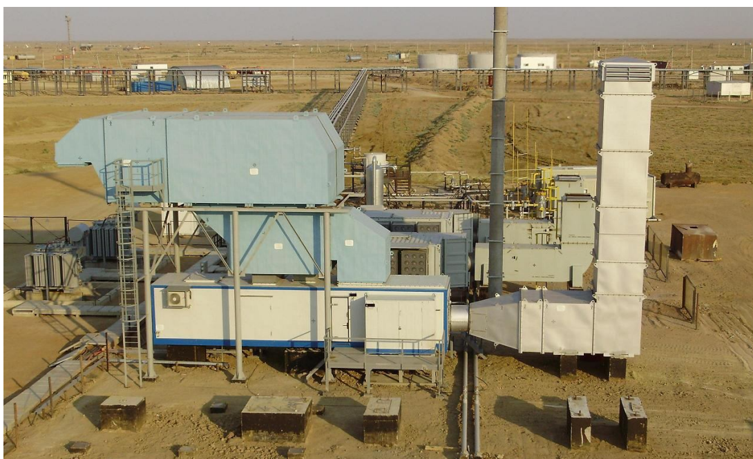
Газотурбинная электростанция ЭГ-2500М1
